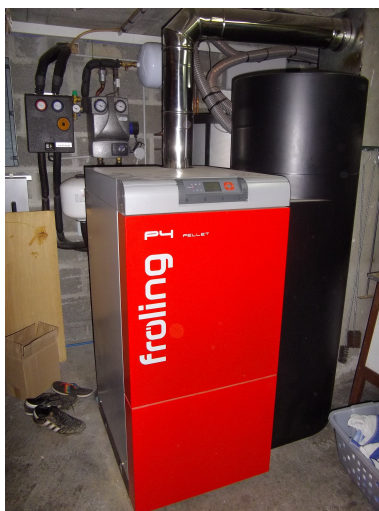
Chaudière à granulés
